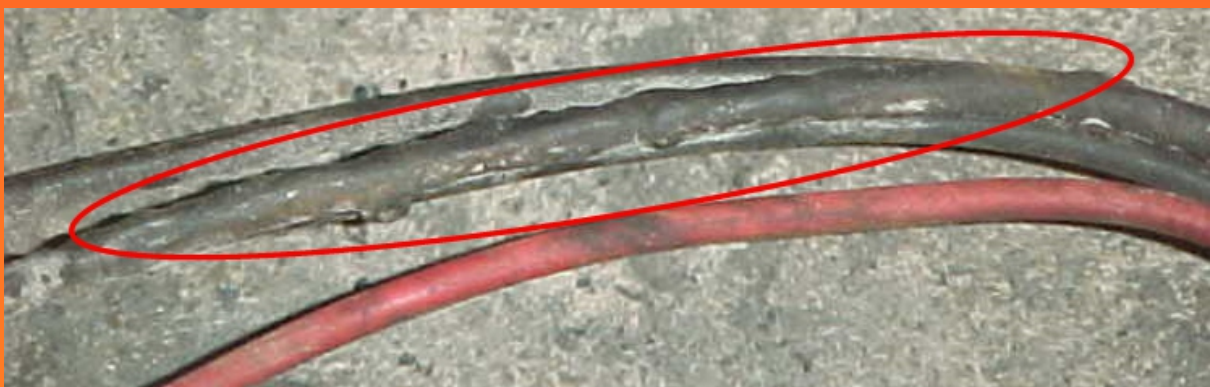
Bolhas de estiramento caracterizando a ocorrência de um aquecimento interno do condutor elétrico.
